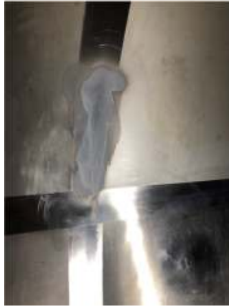
探傷剤にて再検査、ひび割れなし
