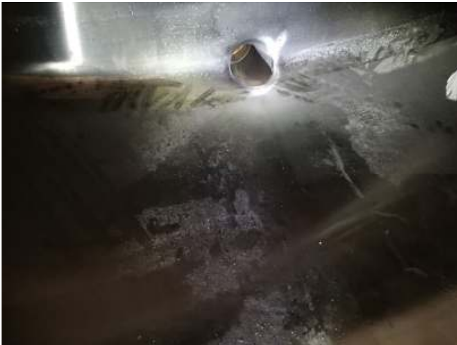
バルク内洗浄不良箇所
