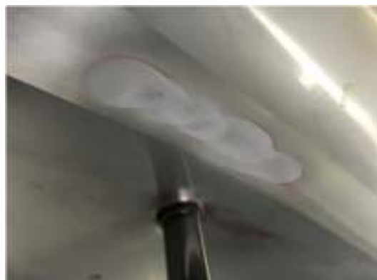
探傷剤にて再検査、ひび割れなし
