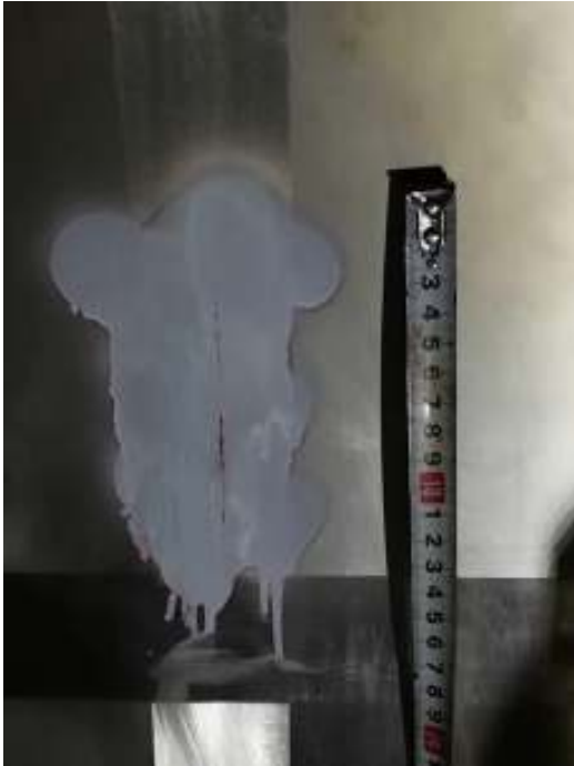
10センチほどのクラック（ひび割れ） →12/17に内部溶接修理を実施
