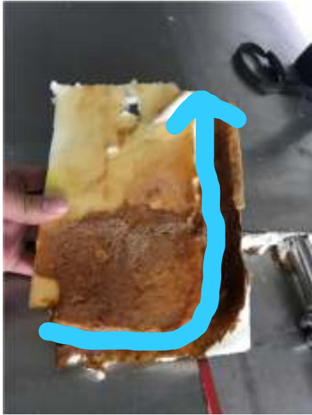
変色した断熱材①
